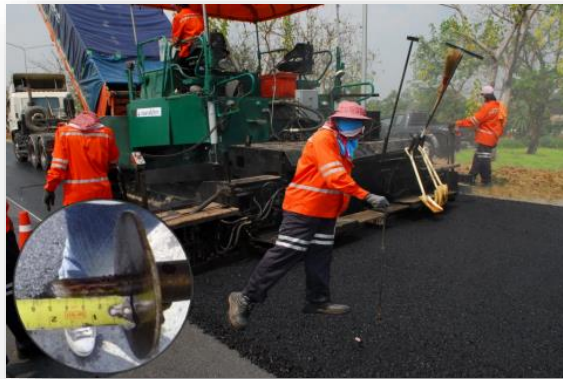
รูปที่ 2.4 การตรวจสอบความหนาเบื้องต้นก่อนทำการบดทับ
