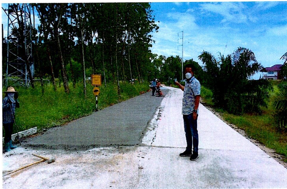
โครงการปรับปรุงถนนคอนกรีตเสริมเหล็กสาย ท.205 หมู่ที่ 2 ตำบลหนองใหญ่ อำเภอนองใหญ่ งบประมาณ 10,058,000 บาท อยู่ระหว่างดำเนินการก่อสร้าง
